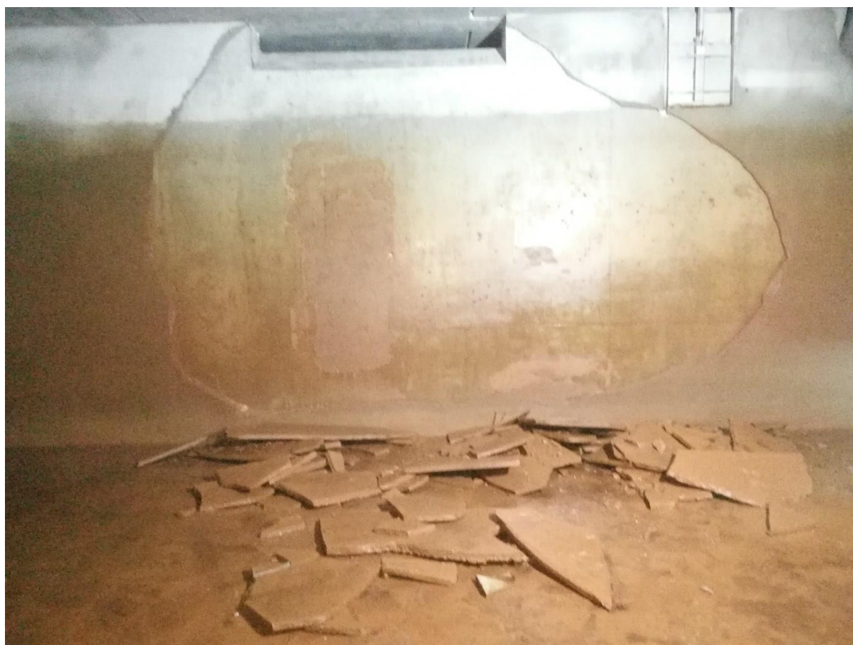
Figure 1 Dégâts constatés sur la bâche Eau Brute
