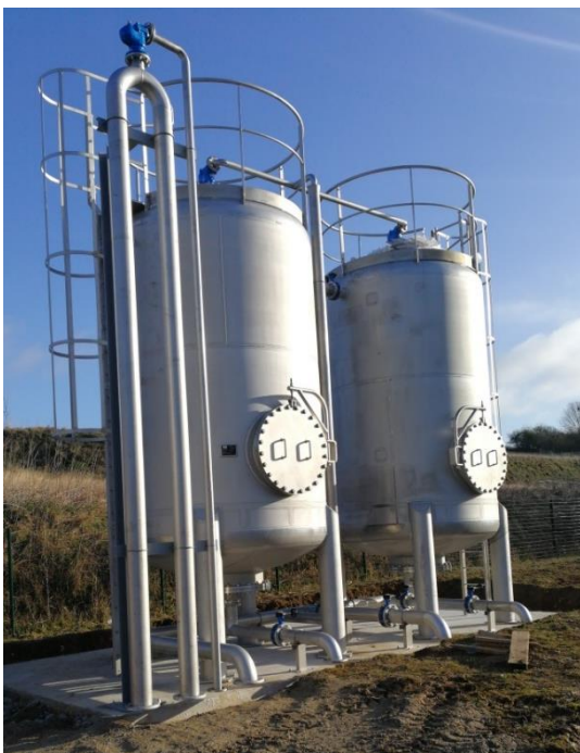
Figure 2 – Tours de filtration sur CAG en place
